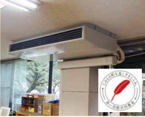
↑新たに設置したセルプひの1階のエアコン
